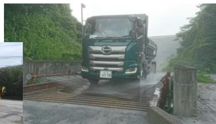
△ダンプの足洗い場
